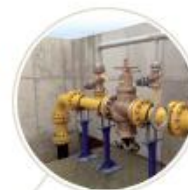
POSTE DE SECTIONNEMENT OXYGÈNE
