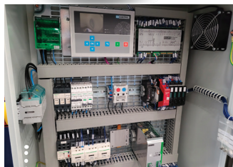
Coffret électrique et automate
