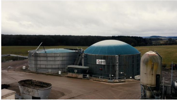
Philippe COLLIN à VITTEL Méthaniseur non raccordé au réseau
